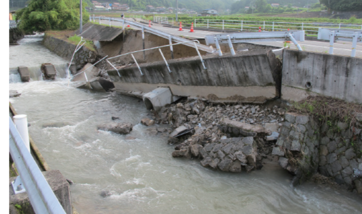
高坂町を流れる河川の水流で削られた歩道
